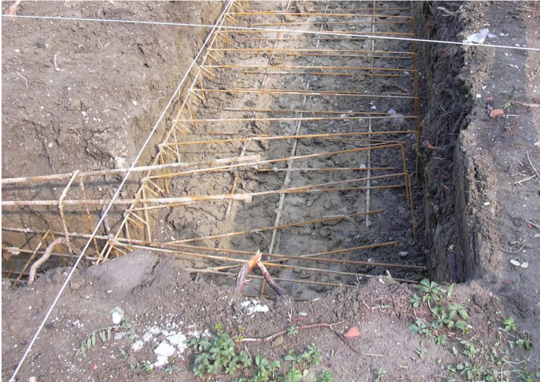
(03) NO – Armatura posata direttamente sul terreno fangoso
