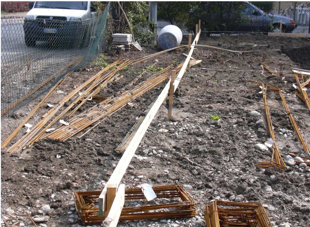
(04) NO – Armatura depositata sul fango ; il ferro va posato su travetti alti che lo mantengano pulito.
