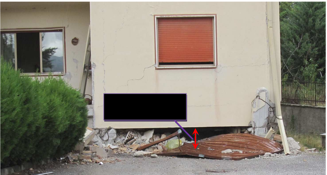
(21) NO – ... e il palazzo di 3 piani + piano terra a garages è “sceso” di due metri ( il piano garages da 250 cm si è ridotto a questo finestrino da 50 cm e sotto c’ erano ancora le automobili schiacciate ) anche se il fabbricato è rimasto praticamente a piombo.
