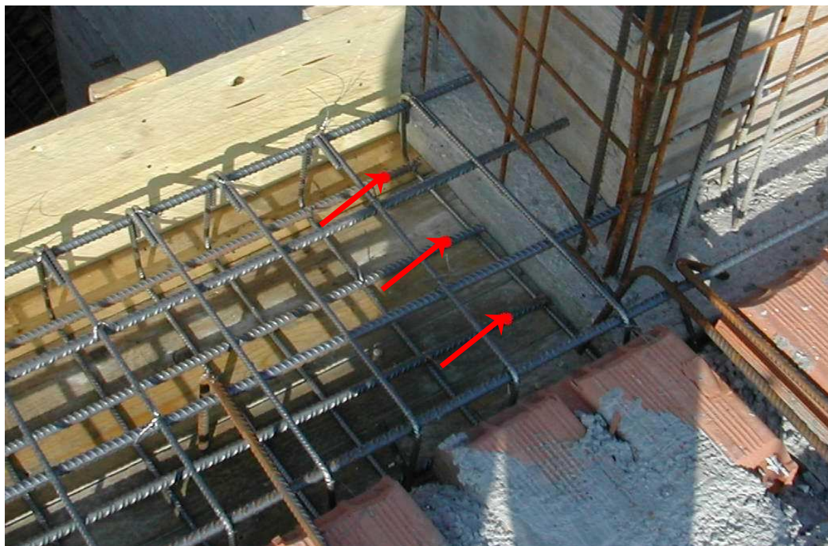
(38) NO – I ferri inferiori NON appoggiavano sul muro in c.a. dell' ascensore, ma solo sul cassero : errore gravissimo .
